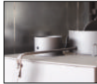
Εξωτερική ρύθμιση του κλαπέτου για καλύτερο έλεγχο της καύσης
